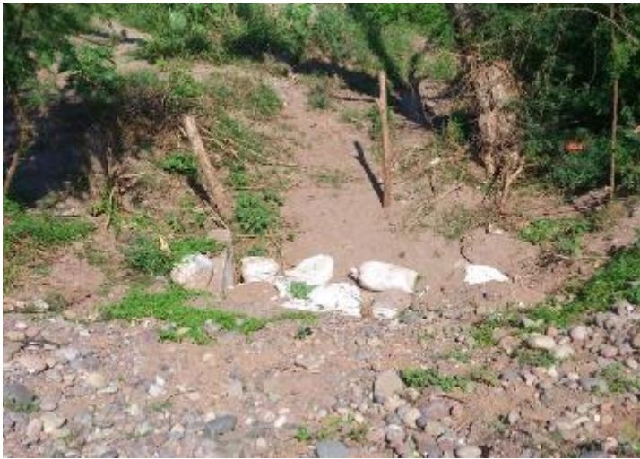
Imagen 124.- A pesar de contar con un muro de contención la fuerza y empuje del agua terminan venciendo al muro, foto: Edgar Palomino.
