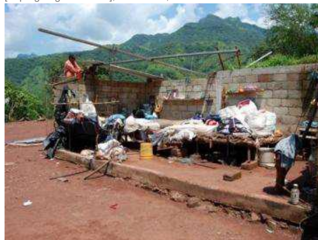
Imagen 5.-Las lluvias derrumban techos y muros en Tiquicheo, fuente La Jornada, Michoacán, Edición Electrónica 2012, En [http://goo.gl/NFXt6I], Febrero 06, 2013.
