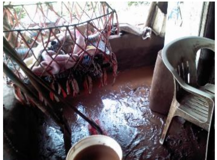
Imagen 136.- Estragos dejados después de que el agua bajara de nivel en las casas de la localidad de El Llano de Zapote Grande foto: H. Ayuntamiento de Tiquicheo.
