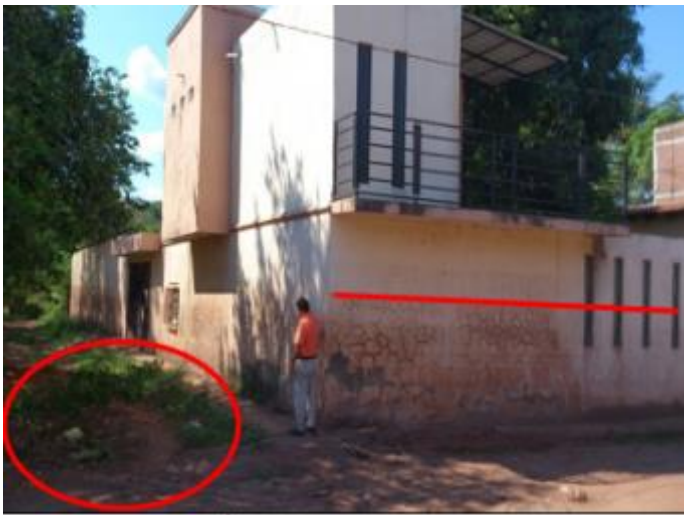
Imagen 120.- Fotografía de las calles de la localidad de Tiquicheo después de la inundación del 21 de septiembre en donde se aprecia el nivel de agua que se alcanzó 1.50 metros de altura, Foto: Edgar Palomino.
